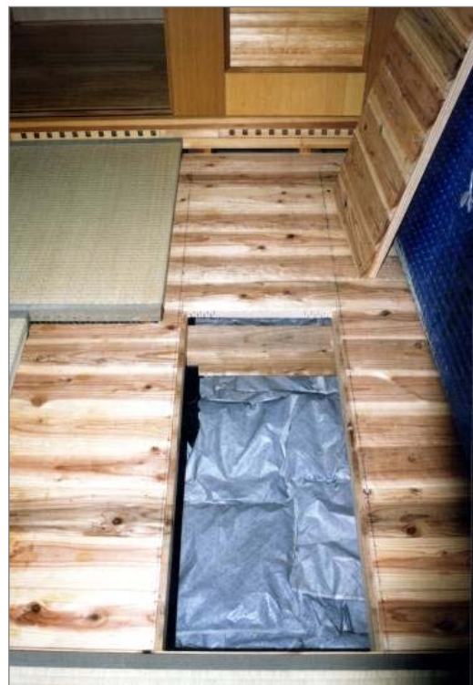
■スギの荒床と床下の廃材木炭
